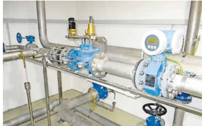
Regelventil und Wasserzählung.
