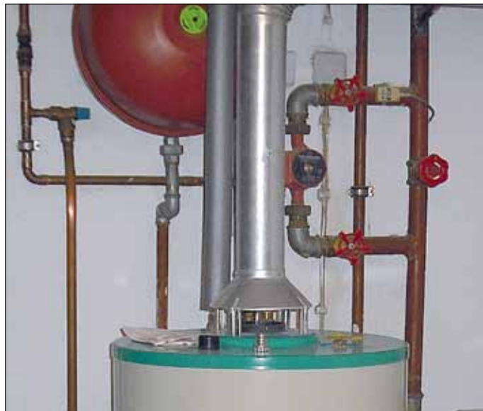
ungedämmte Rohre verlieren viel Energie
