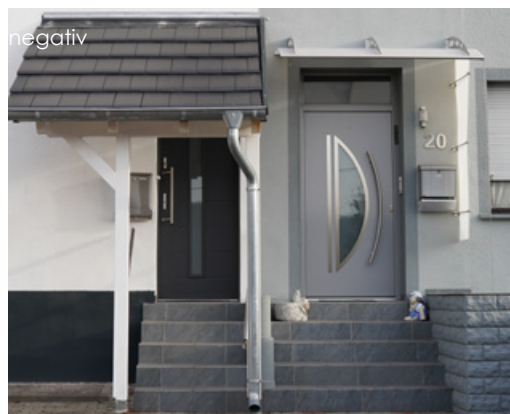
nicht aufeinander abgestimmte zu massive Bauweise
