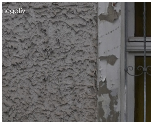
Rauputz und renovierungsbedürftiges Gewand
