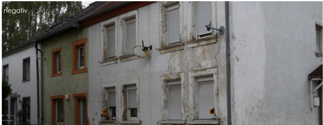
historische Fassade in sanierungsbedürftigem Zustand
