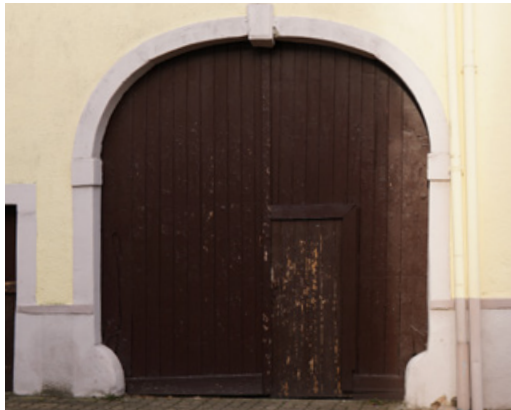
braunes Scheunentor mit leichten Lackschäden
